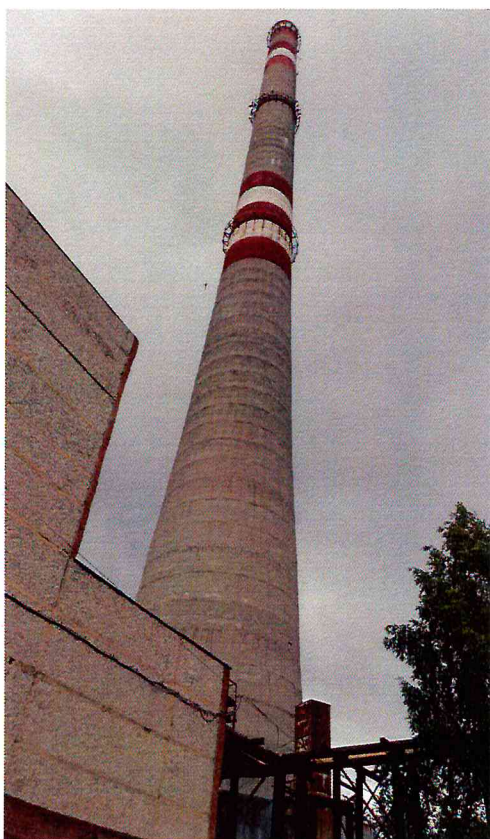
Фото 8. - Дымовая труба 180м Водогрейная котельная
