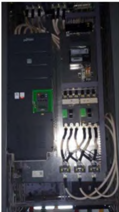
Фото 12.1. – Частотные дымососа и вентилятора на паровом котле №2.
