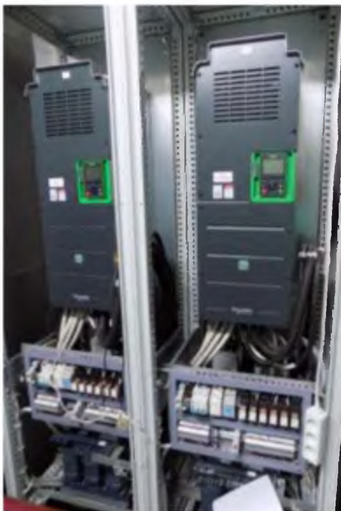
Фото 10.1. – Частотные дымососа и вентилятора на паровом котле №4.
