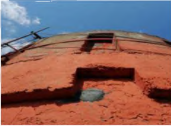
Фото 3.3. – Вымывание фигурного оголовка атмосферными осадками и дымовыми газами
