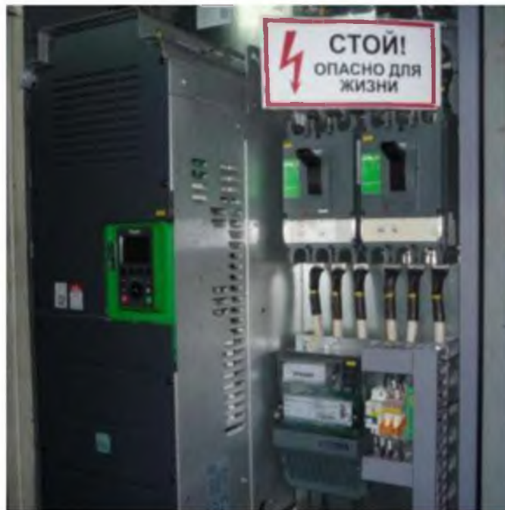
Фото 11.1.- Частотные дымососа и вентилятора на паровом котле №1.
