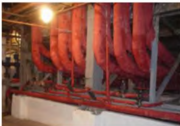
Фото 13.2. Холодная воронка на паровом котле №2
